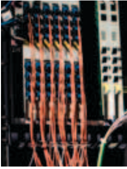
TEILE EINES SERVERS DER TELEKOM IN WIEN: Modernisierungsschritt im Inneren des Netzes unter der Chiffre All-IP.
